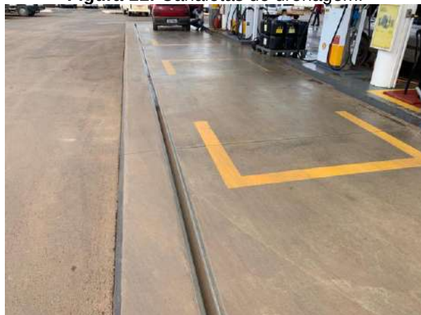
Figura 11: Canaletas de drenagem.
