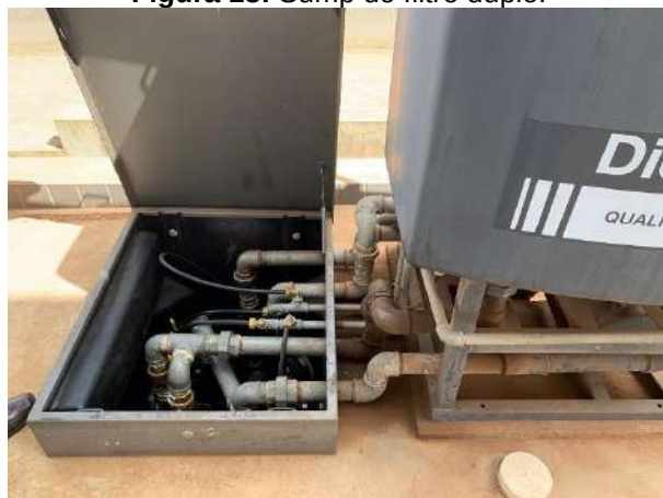
Figura 13: Sump do filtro duplo.
