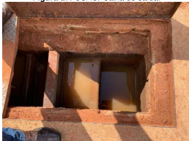
Figura 17: CSAO/ Caixa de saída.
